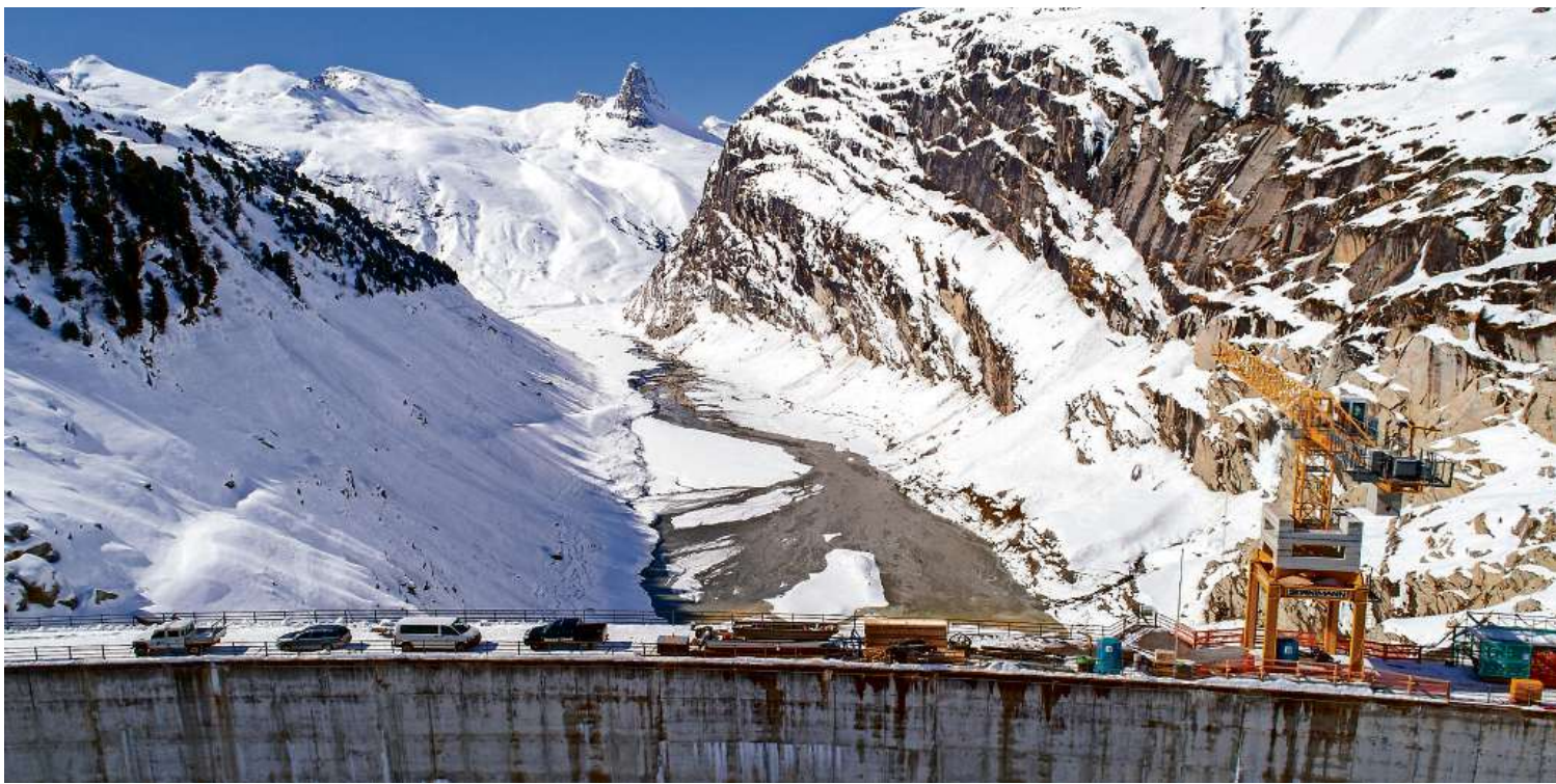
Baustelle Wasserkraft: Für das künftige Wasserzinsmodell wird vollständige Transparenz bezüglich Kosten und Erlöse gefordert. Im Bild die Erneuerung der Stauanlage Zervreila. (FOTO MARCO HARTMANN)
