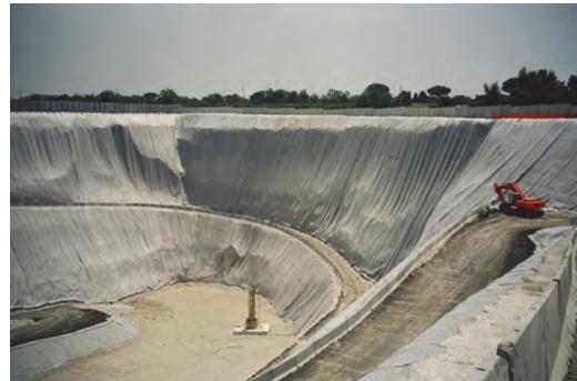
Abb. 4.12: Drainage in einer Mülldeponie, Italien
