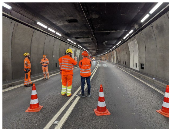
Abbildung 16 Risse in der Zwischendecke der ersten Röhre des Gotthard Strassentunnels Thesisarbeit von Kevin Moar Rana
