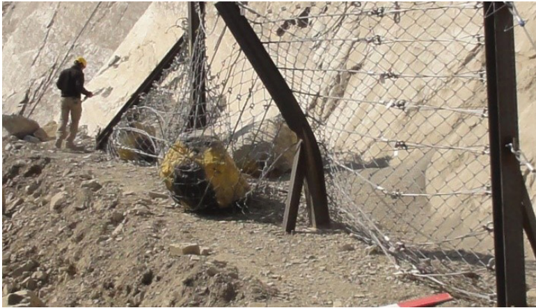
Steinschlagbarriere, welche bei Steinschlagversuchen den Pfosten verbog.
