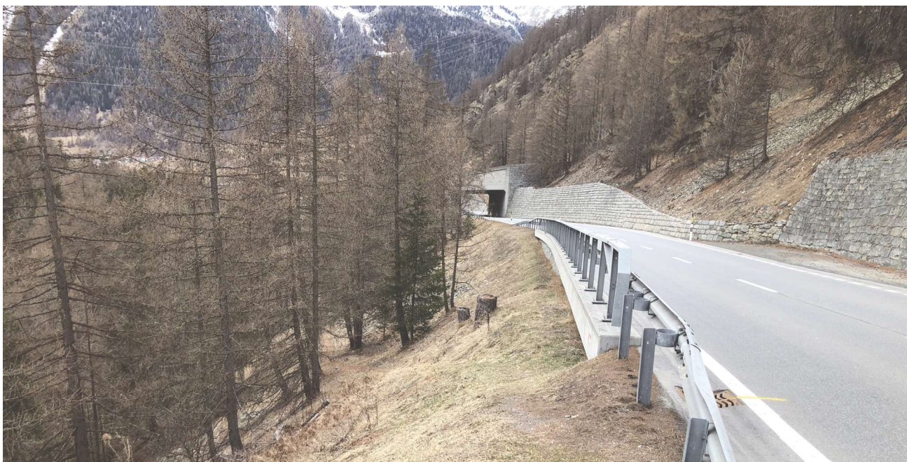
Abb. 7: Gefährdeter Strassenabschnitt an der H28
