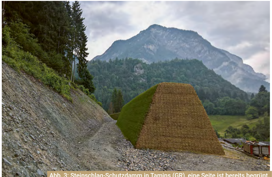
Abb. 3: Steinschlag-Schutzdamm in Tamins (GR), eine Seite ist bereits begrünt.
